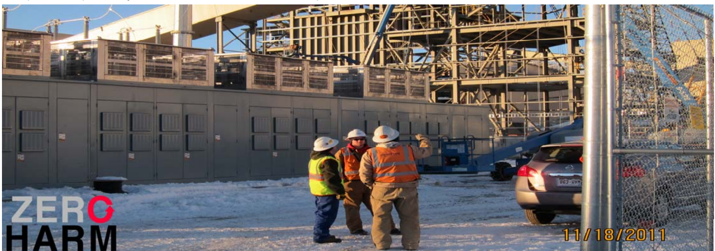
En la foto un filtro de armónicos Metal-Enclosed de gran envergadura instalado en una planta de concentración y flotación minera en Estados Unidos. NEPSI y nuestros equipos se enmarcan en una cultura y política contribuyendo hacia "Cero-Daño". En forma inherente, nuestros equipos entregan insuperables características de confiabilidad y seguridad (Bloqueo a accesos a partes activas), mínima y rápida mantención y sinnúmero de otras características de control y protección para prevenir y evitar incidentes, incidentes y operaciones no seguras que son muy superiores a la industria
