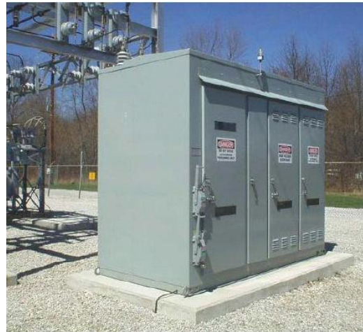
Figura: 100-00-1 Banco de Condensadores con Gabinete Metálico, diseñado y construido bajo sus requerimientos
